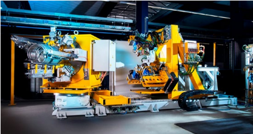
Die neue Nimak-Schweißanlage , die bei Bosch Home Comfort in der Fertigung von Heizspiralen zum Einsatz kommt. Links das aufgespannte Werkstück, das über einen Drehtisch in die exakte Schweißposition gebracht wird.
