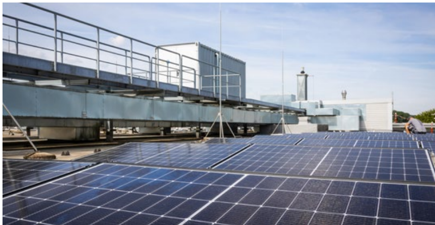
Haimer betreibt drei PV-Anlagen mit 2.200 Modulen. Diese erzeugen 700.000 kWh Strom bei 92 % Eigenverbrauchsquote.
