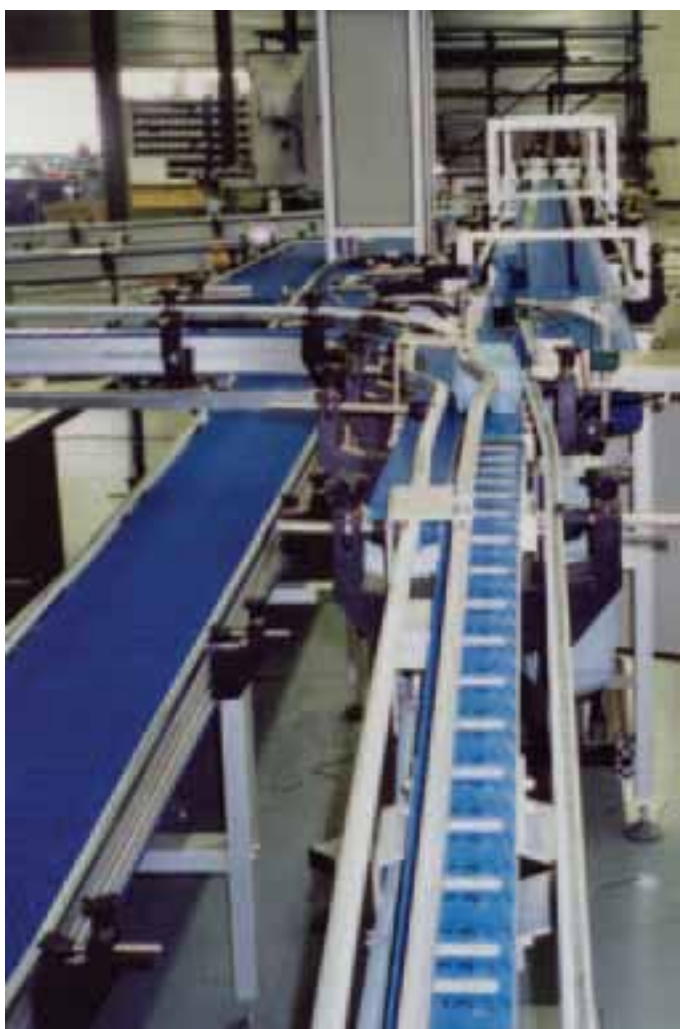
Bild 2: Blick aufs Steigförderband (rechts) und auf den Breitbandförderer mit integrierter Staustrecke
